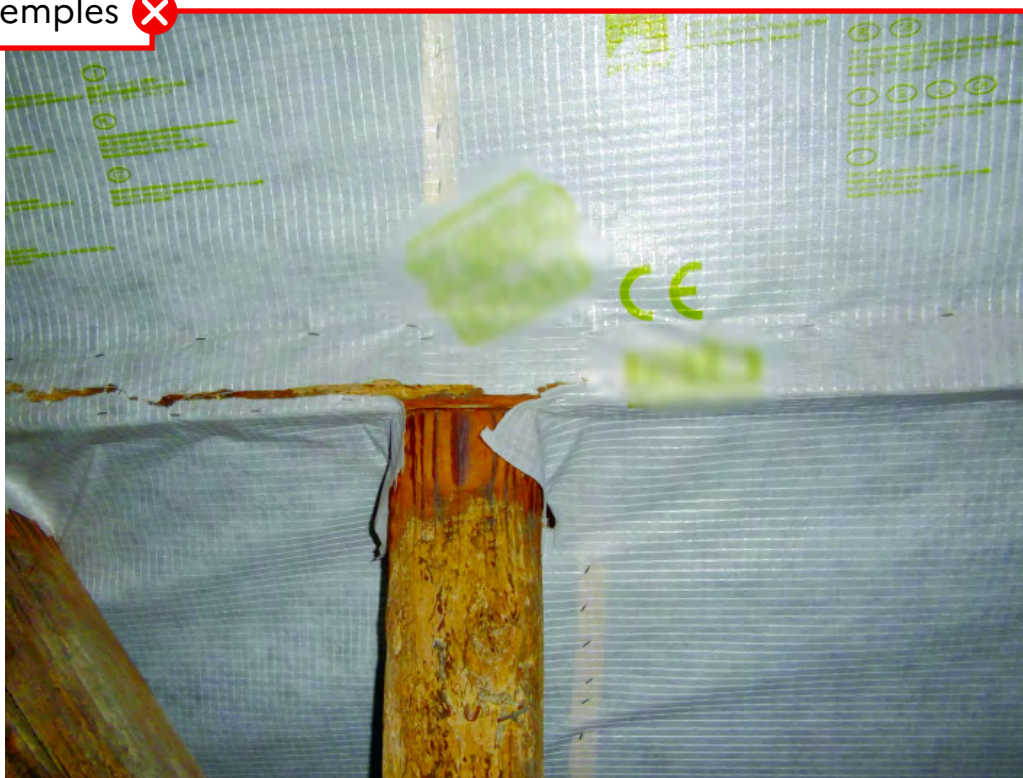
Figure 25 : La membrane est déchirée au droit des éléments de charpente la traversant. Elle n'est fixée que par des agrafes. Aucune reprise n'a été effectuée.
