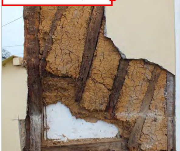
Figure 42 : Rénovation d'une maison en pisé sans prendre en compte les enjeux d'humidité dans le mur
