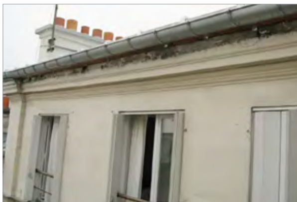
18 rue Caffarelli (Paris III e ) avant rénovation de la toiture : la gouttière repose directement sur la corniche.
