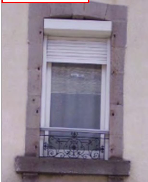
Figure 59 : Caisson de volet roulant extérieur en protrusion par rapport à l'encadrement
