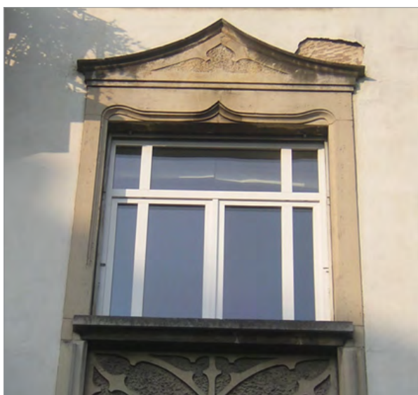
Figure 67 : Le remplacement de la fenêtre a conduit à l'appauvrissement des moulures et à la modification des proportions de la fenêtre. Avant (haut), après (bas).
