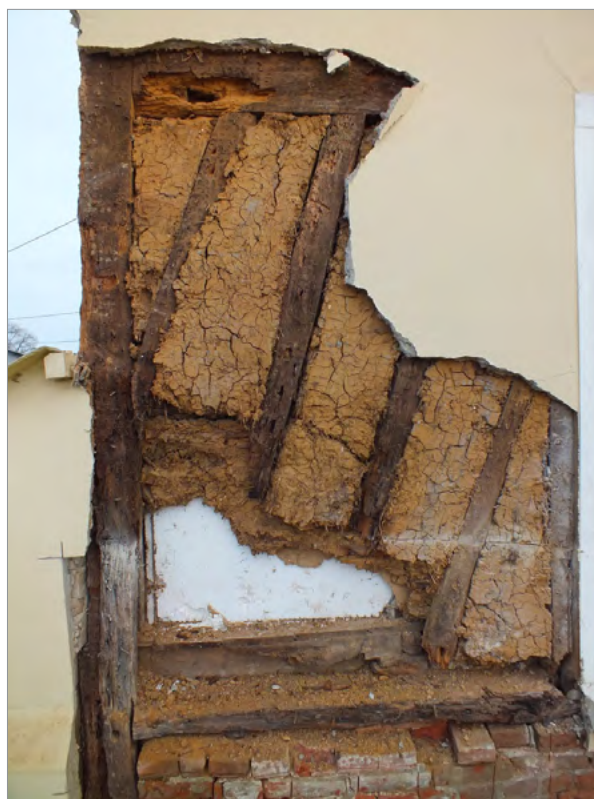
Figure 10 : Un mur en pan de bois victime d'un mauvais usage de matériaux contemporains (polystyrène et enduit ciment) © CARPENTIER charpente construction bois
