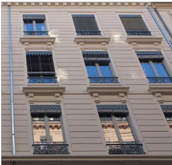
Figure 69 : Les fenêtres de cet immeuble ont toutes été changées pour un modèle simple en double vitrage, dont le dessin et la couleur respectent l'esprit des fenêtres d'origine. Les jalousies et les lambrequins qui les cachent ont également été restitués (69).
