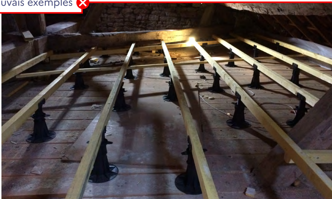
Figure 22 : Le plancher bois du comble va recevoir l'isolant mais il n'est pas étanche à l'air. De nombreux passages d'air existent entre les lames.
