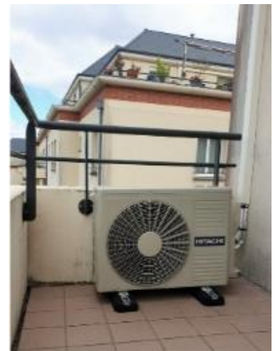
Unité extérieure de mono split disposée en balcon
